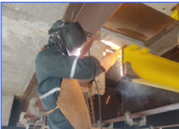
SOLDAGEM NAS VIAS DE ROLAMENTO DAS PLATAFORMAS DE INSPEÇÃO E MANUTENÇÃO DA PONTE
